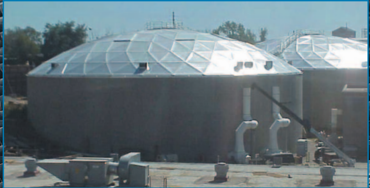
Instalação de meios filtrantes de fluxo vertical AccuPac Morris Forman WWTP, Louisville, KY, EUA
